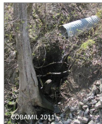
FIGURE 8: ÉMISSAIRE D'ÉGOUT PLUVIAL CAUSANT L'ÉROSION DU TALUS SUR LA RIVIÈRE SAINT-PIERRE À MASCOUCHE
