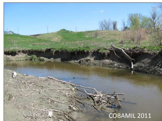
FIGURE 1 : ÉROSION SUR LA BERGE DU RUISSEAU LA CORNE (RIVE CONCAVE D'UN MÉANDRE)
