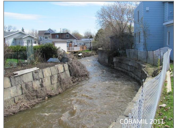
FIGURE 28 : ARTIFICIALISATION DES BERGES DE LA RIVIÈRE AUX CHIENS, SECTEUR DU VIEUX SAINTE-THÉRÈSE
